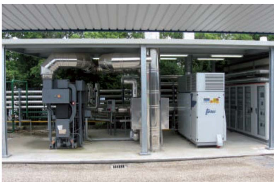
Figura 5 - Impianto di trigenerazione
